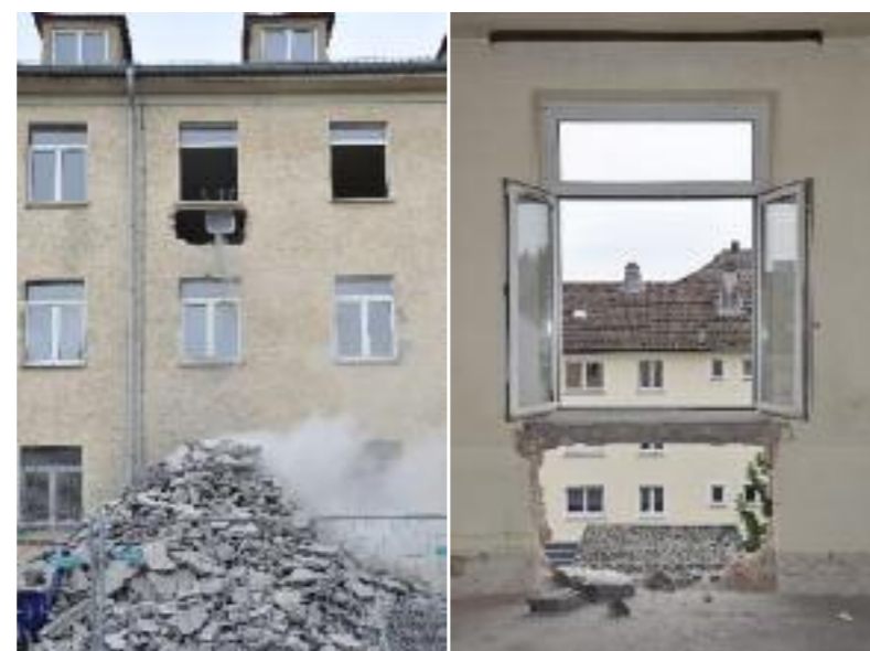
Die Sanierung der ehemaligen Kaserne ist aufwendig: Sämtliche Fenster, Türen und Bodenbeläge wurden entfernt. Die Verglasungen sollen in den neuen Wohnungen bodentief sein.
