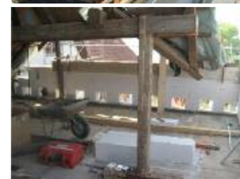
Das Dach war marode und konnte nicht erhalten werden. Gebälk und Eindeckung wurden erneuert.
